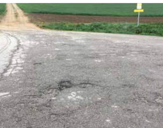
Die Gemeindestraße Wetzlar ist in einem sichtbar schlechtem Zustand
